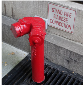
รูปที่ 9.5 หัวต่อน้ำดับเพลิงเข้าอาคาร
