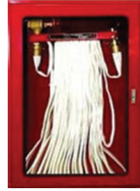
สายฉีดน้ำดับเพลิง
