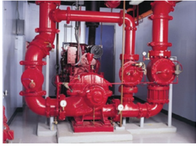
ปั้มน้ำดับเพลิง
