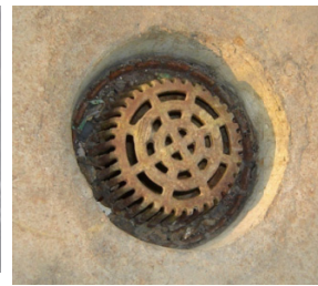
ค. การติดตั้งที่ไม่ดี
