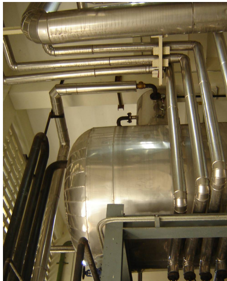
รูปที่ 12.3 ท่อไอน้ำที่หุ้มฉนวนและท่อด้วยแผ่นอลูมิเนียม
