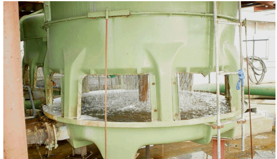
Cooling Tower (ขนาดเล็ก)
