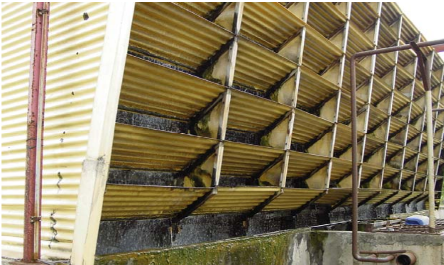
Cooling Tower (ขนาดใหญ่)
